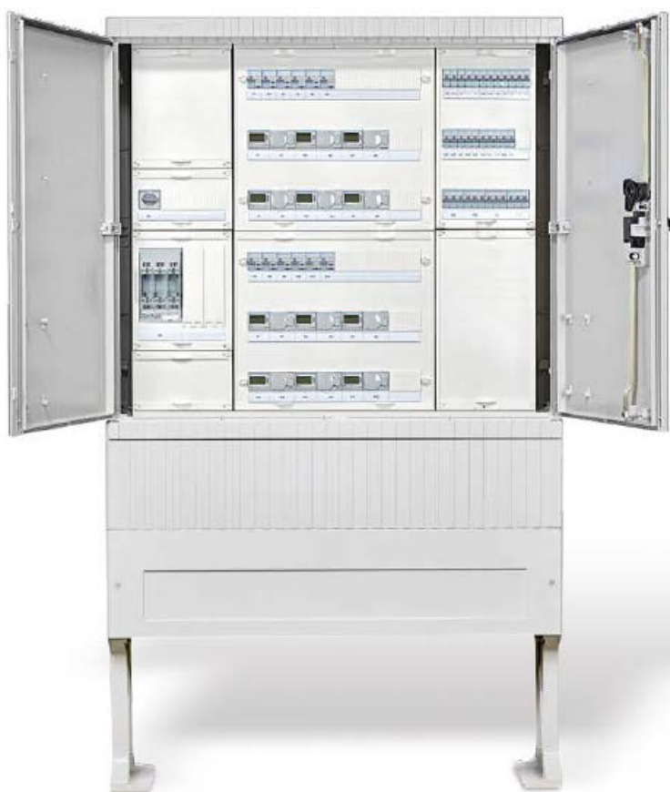
skap ZAL64U + sokkel ZAX007
